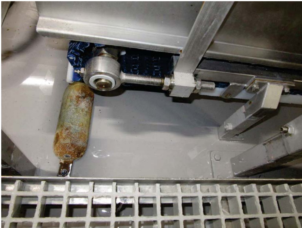
Figur 28. Anode er påmontert dekk. Siden anoden ikke er fullstendig neddykket, kan rekkevidden til anoden være begrenset på grunn av en tynn vannfilm
